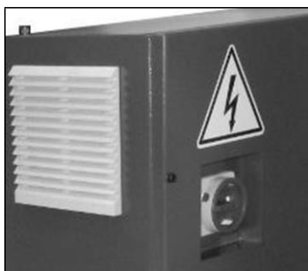
Главный выключатель – электропитание шкафа управления.
